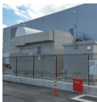
宮城物流センターの自家発電設備
