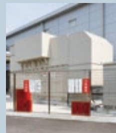
72時間対応の自家発電設備を東名阪に配備
