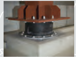
最先端の免震構造を導入
