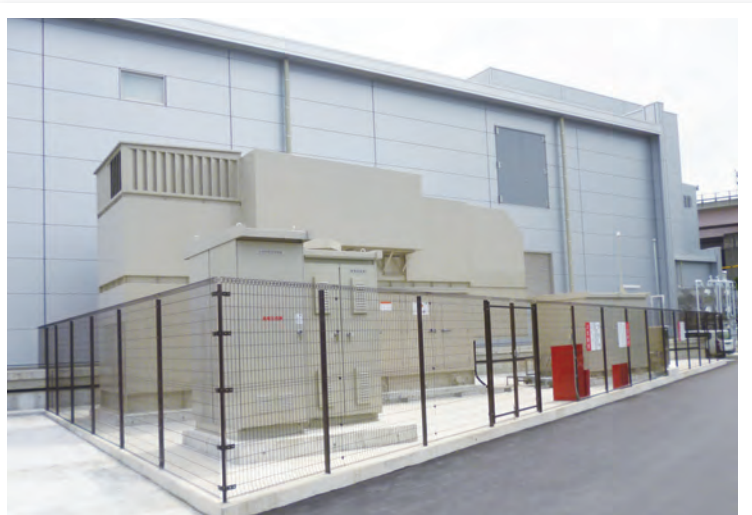
スズケン名南物流センターの非常用自家発電機
