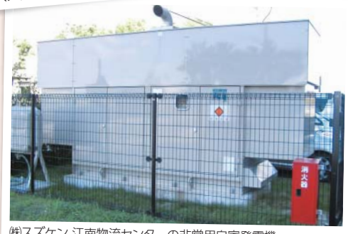
(株)スズケン 江南物流センターの非常用自家発電機
